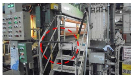
進入防止扉と電磁ロック（インターロック付き）
