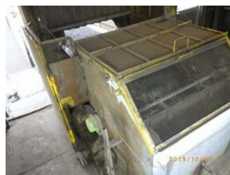
ベルトコンベアのドラム部の防護カバー
